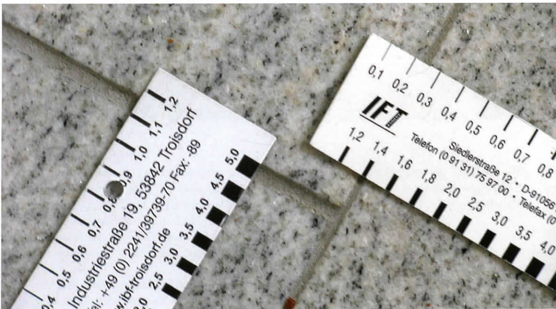
Stark voneinander abweichende Fugenbreiten innerhalb eines Bodenbelags
